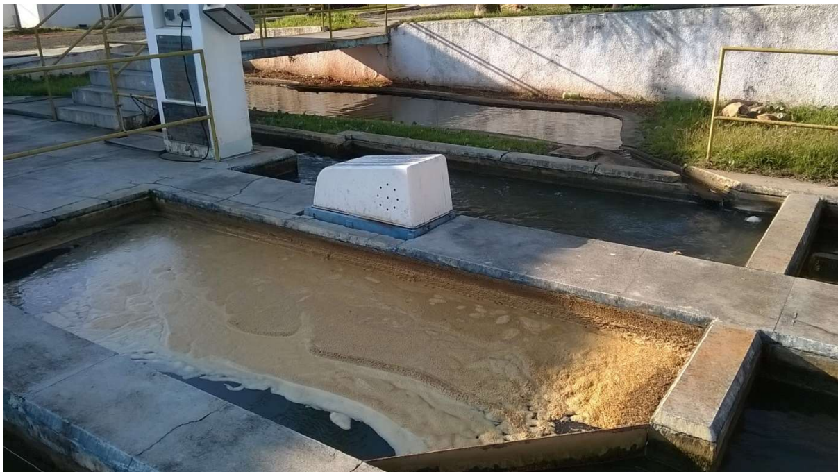
Figura 4.4 - Vista da primeira câmara de floculação
