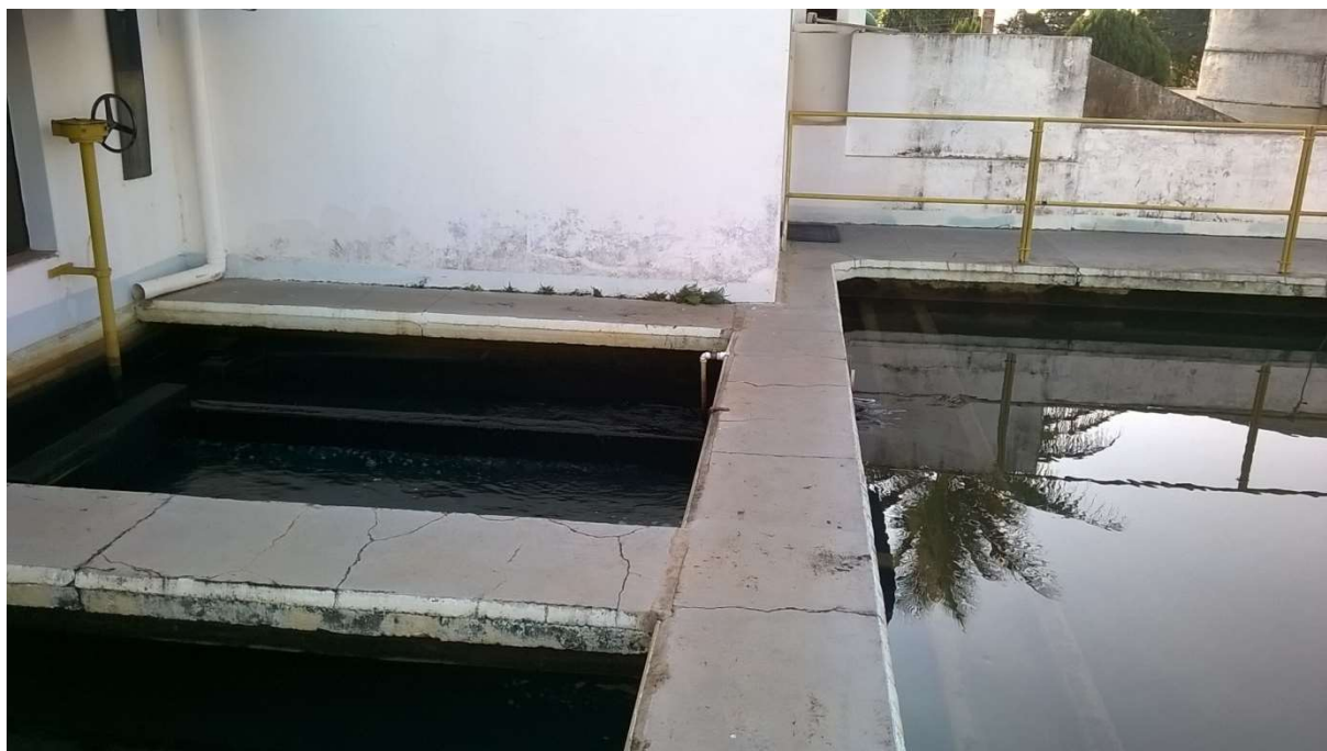
Figura 4.9 - Vista parcial dos filtros
