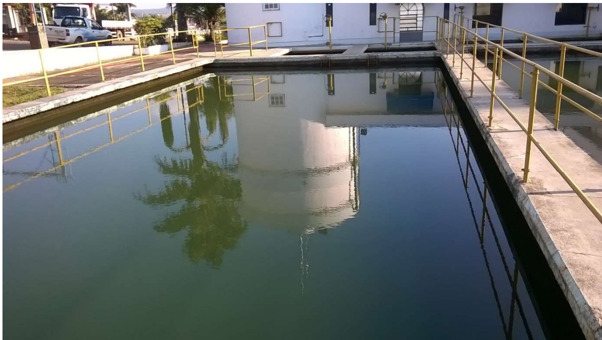
Figura 4.6 - Vista geral de um dos decantadores
