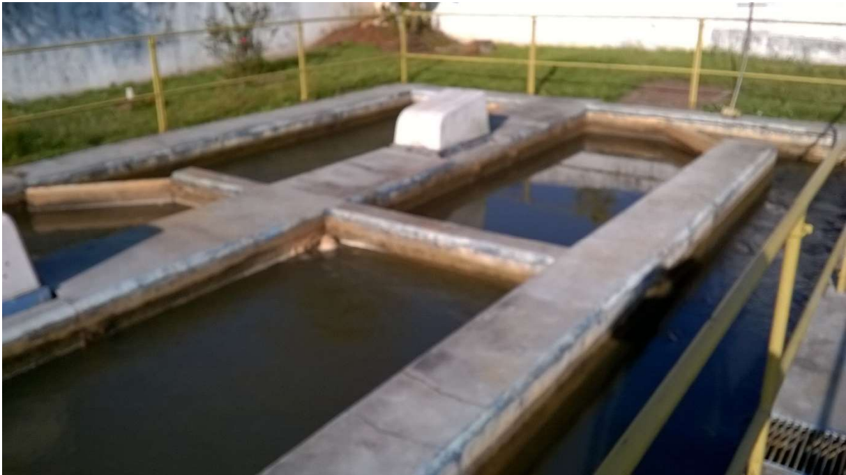
Figura 4.5 - Vista da segunda e terceira câmaras de floculação, bem como do canal de água floculada
