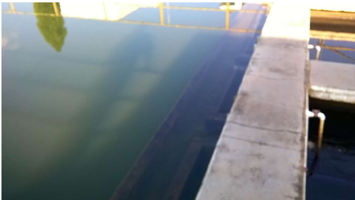
Figura 4.7 - Detalhe da calha de coleta de água decantada em condição afogada
